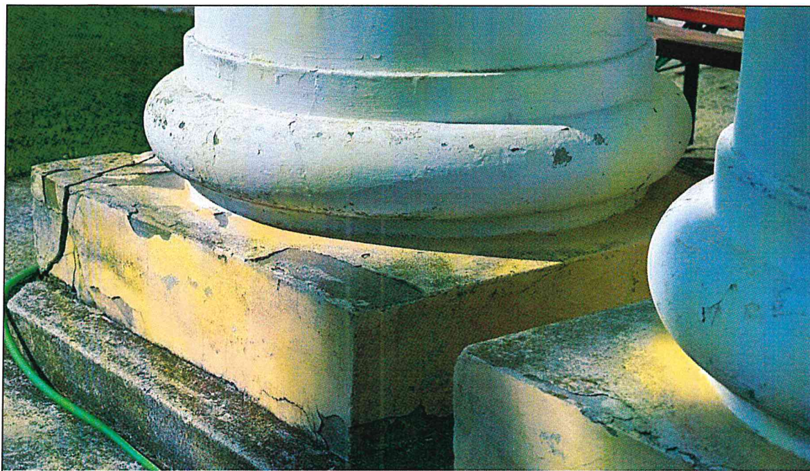
Fot. 12. Pękające, betonowe podstawy kolumn portyku oraz niestarannie wykonane i łuszczące się reperacje kolumn.
