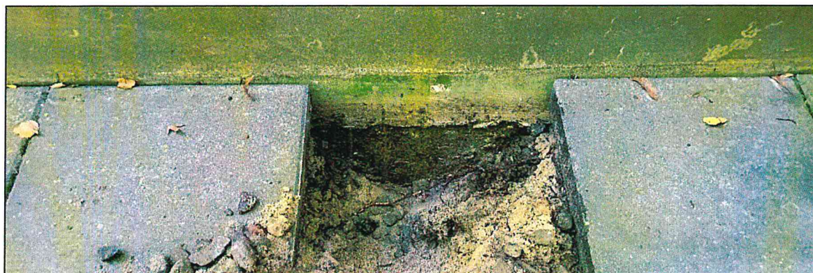
Fot. 7. Brak iniekcji przeciwwilgociowej na ścianach prezbiterium.
