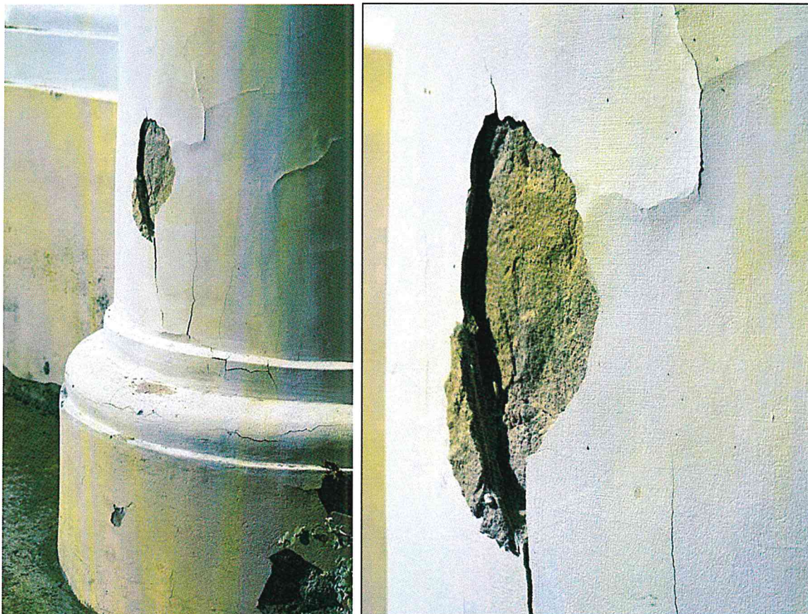
Fot. 13. Fot. 14. Zdegradowane, pękające i odpadające tynki kolumn z cementowymi reperacjami które przyspieszają destrukcję.
