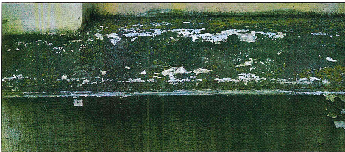
Fot. 6. Intensywny porost mikroorganizmów na cokole prezbiterium na skutek silnego zawilgocenia.
