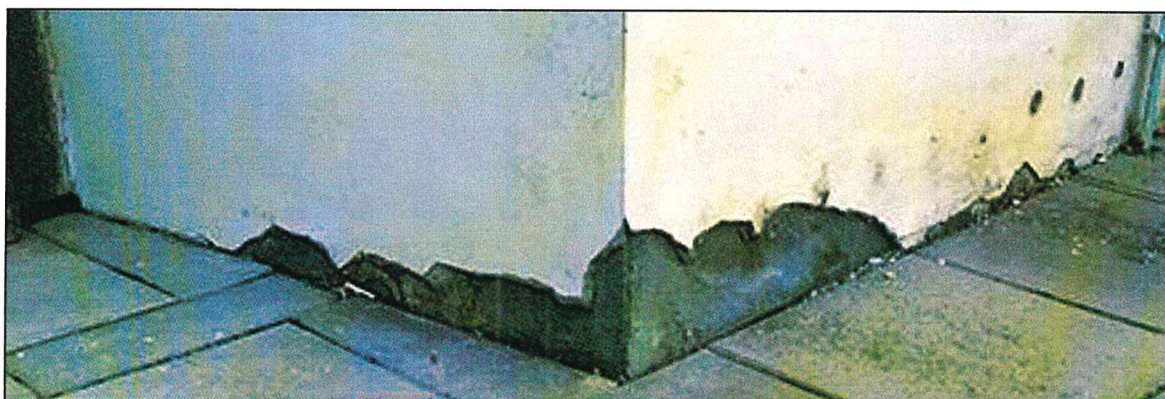
Fot. 3. Odpadająca od źle opracowanego tynku renowacyjnego „szlichta” nawierzchniowa. Iniekcje przeciwwilgociowe ściany frontowej wykonane od strony zewnętrznej.
