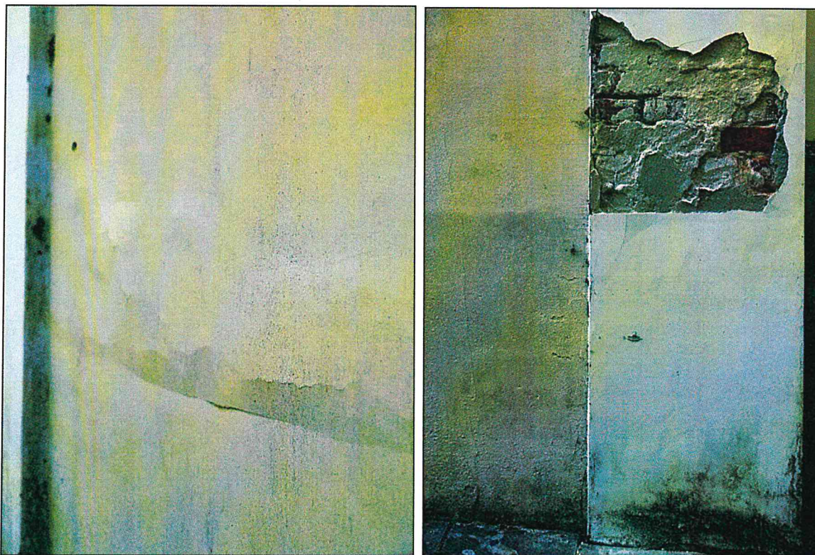
Fot. 20. Fot. 21. Uszkodzenia wapiennych tynków ścian zakrystii powyżej wykonanych z zaprawy cementowej „reperacji”.
