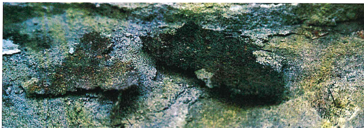
Fot. 10. Gruba warstwa gruntu akrylowego pod wtórnymi tynkami; warstwa ta, położona bez należytego oczyszczenia powierzchni odspaja się od podłoża.
