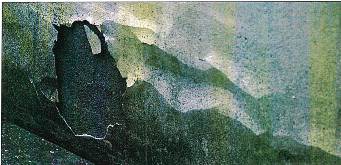
Fot. 16. Łuszcząca się i odpadająca od źle opracowanego tynku renowacyjnego „szlichta” nawierzchniowa.
