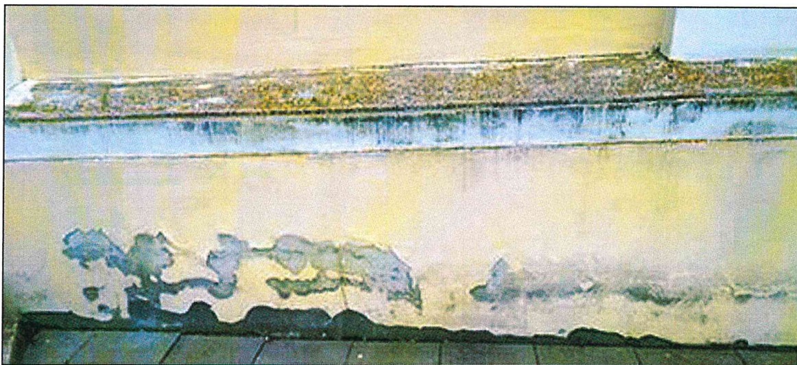
Fot. 2. Łuszcząca się i odpadająca od źle opracowanego tynku renowacyjnego „szlichta” nawierzchniowa. Porosty na powierzchni gzymsu.
